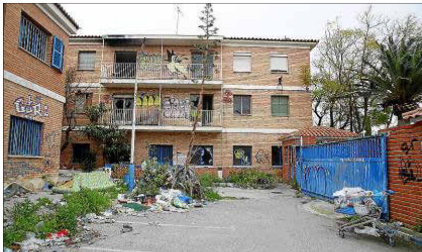
El estado actual de la vieja cárcel es de abandono y degradación.
